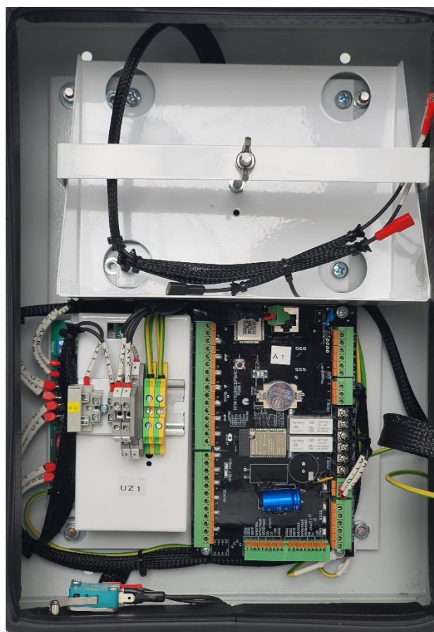
Рисунок 1.4 - Общий вид шкафа
